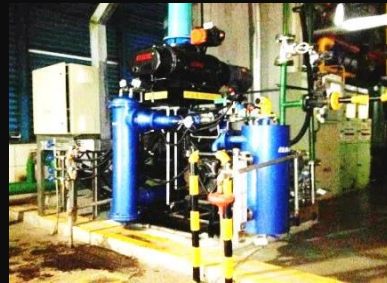
Energieeinsparung in Kraftwerken
