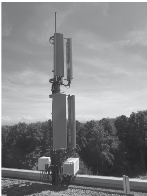
Beispiel einer Mobilfunkanlage
